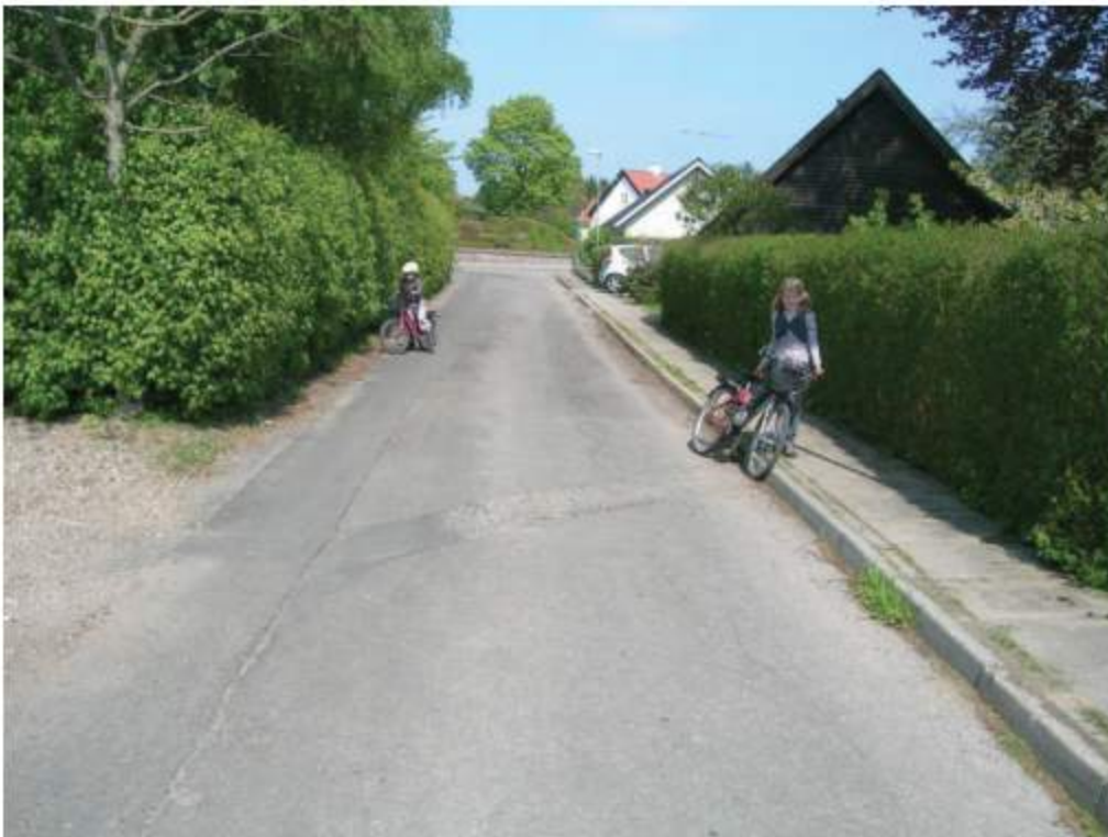
Eksempel 2. Trafikklasse T1 Restlevetid: 29 %
